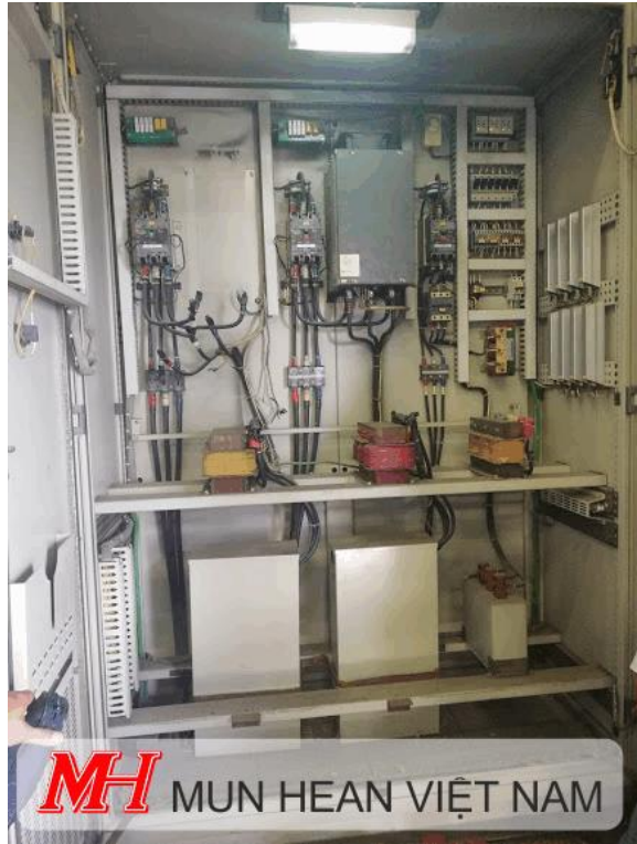
Hệ thống tủ bù truyền thống cũ
